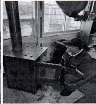
MANTENCIÓN DE ESTUFAS
