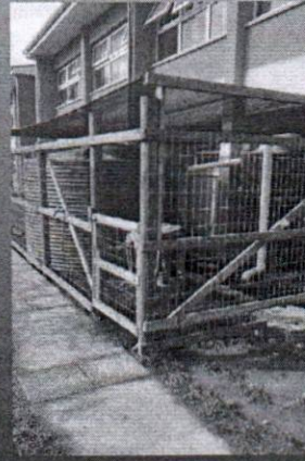
COSECHADORES AGUAS LLUVIAS ESCUELA SAN LUIS
